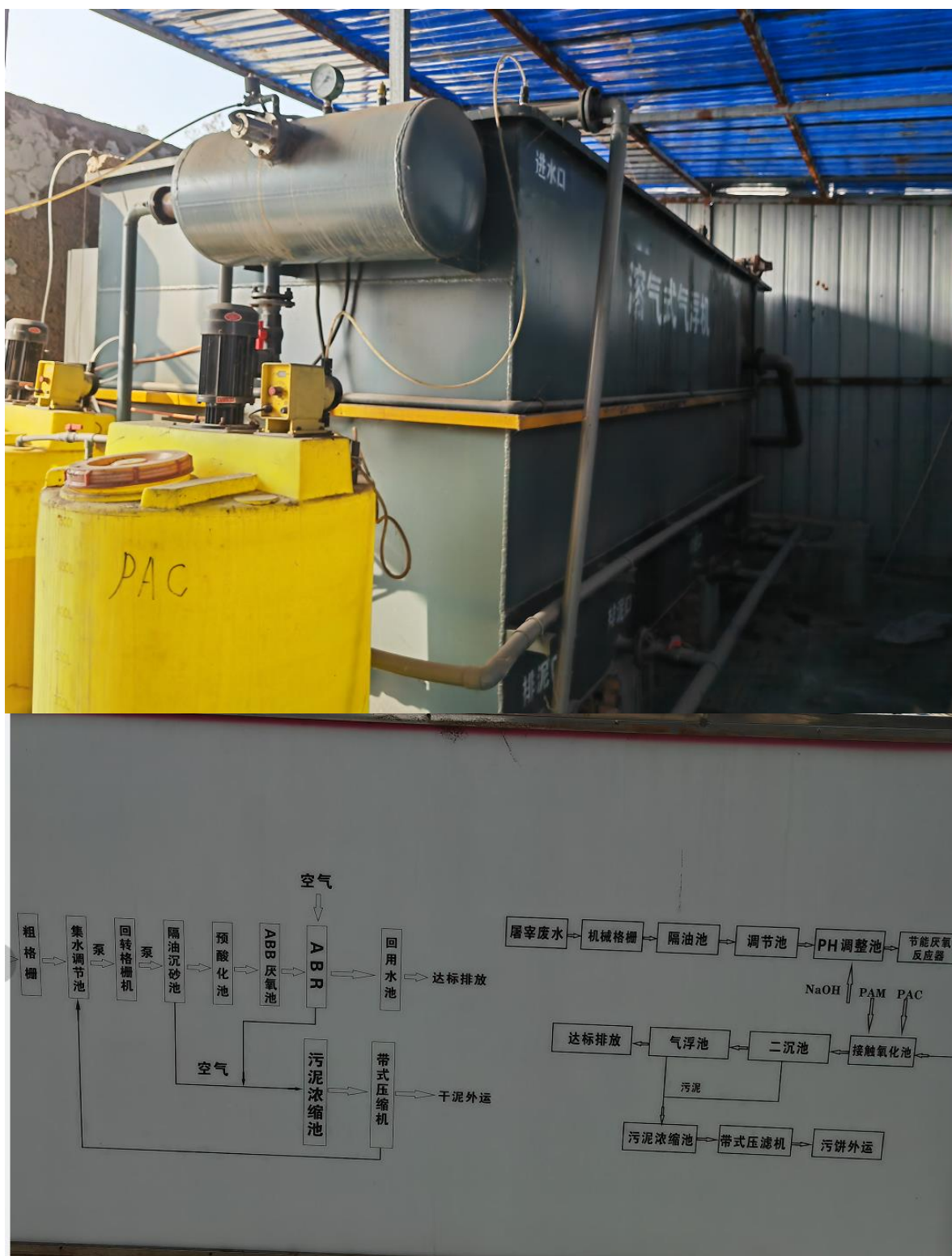
图 4.1-2 项目区污水处理站设施图
