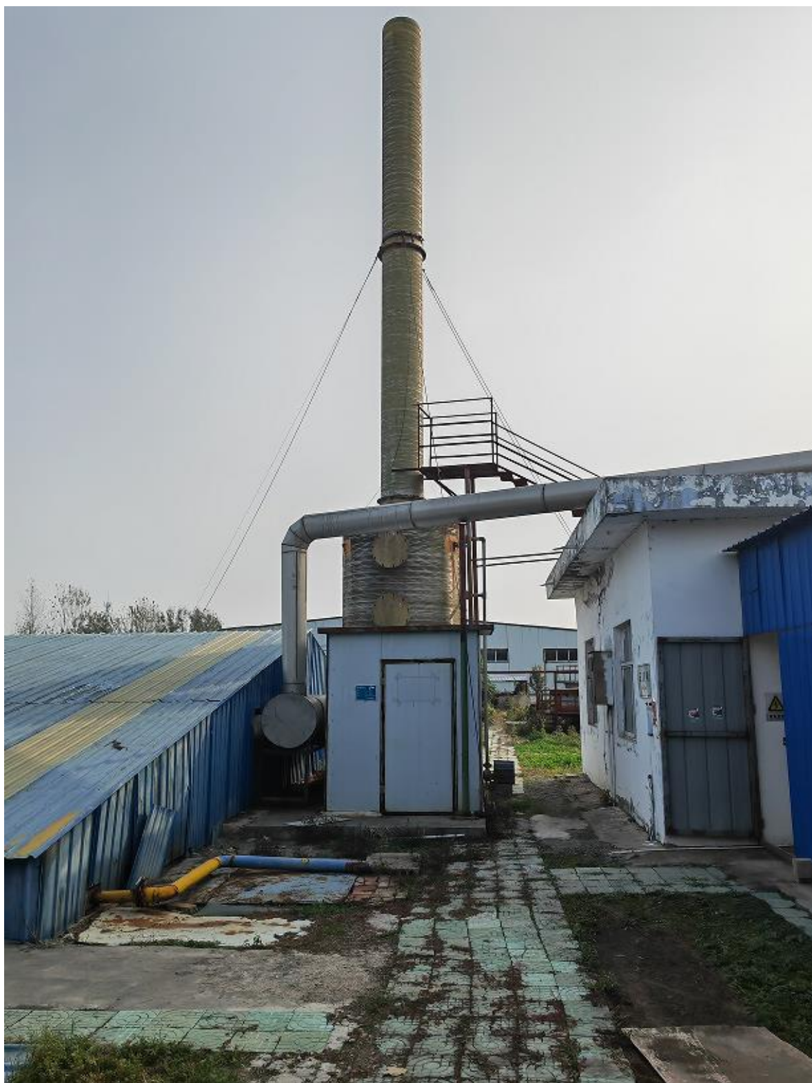
图 4.1-5 项目依托污水处理站废气处理系统现场图
