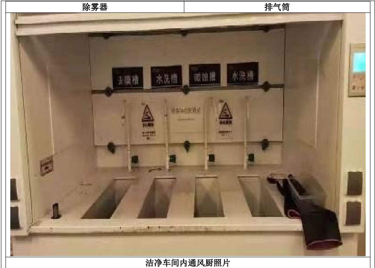
图 3-2 废气处理设施及排气筒图片
