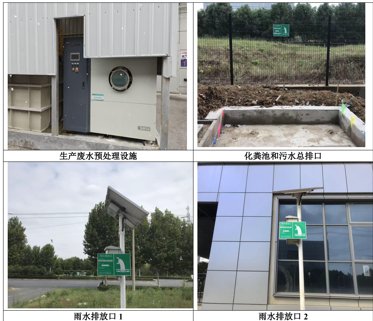
图 3-1 本项目预处理设施及污水和雨水排口图片
