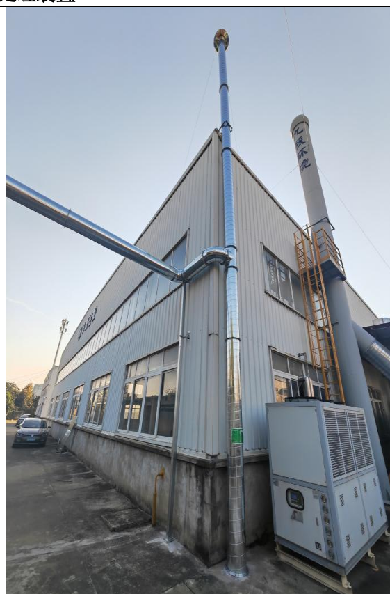
DA001 和 DA003 排气筒
