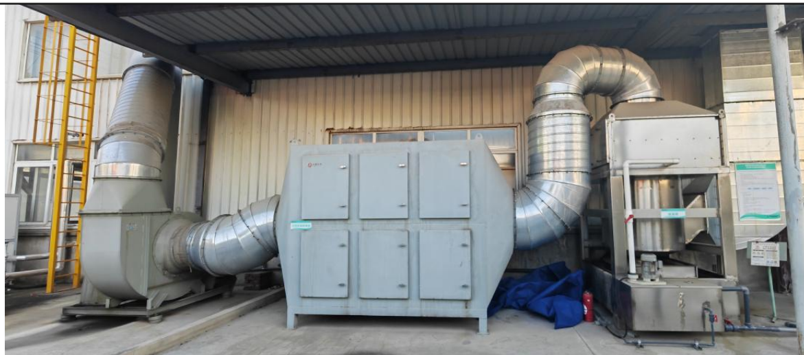
烘干固化废气处理装置
