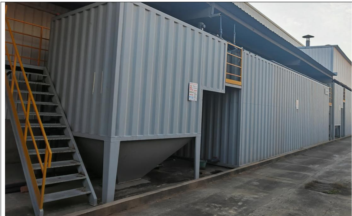
图 3-2 项目污水处理设施照片
