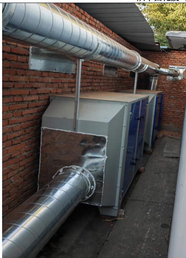
危废暂存间废气处理装置（两级活性炭）
