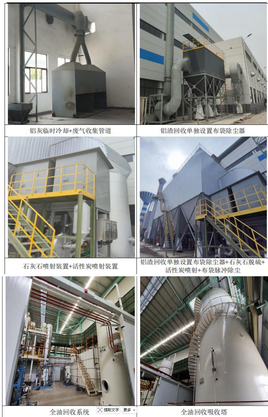
图 4.1-4 部分废气处理设施
