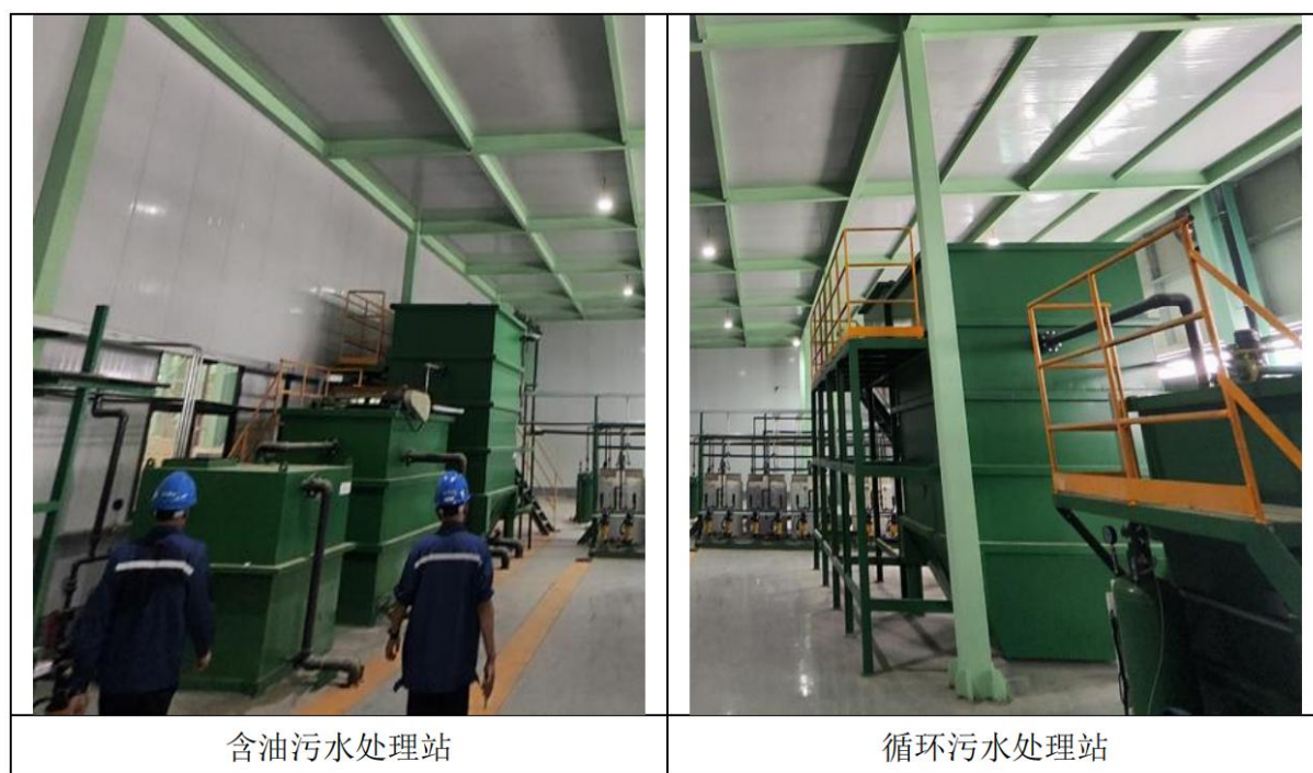
图 4.1-3 废水处理设施
