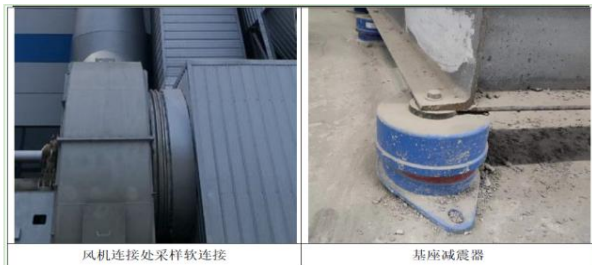
图 4.1-5 部分设施减振措施
